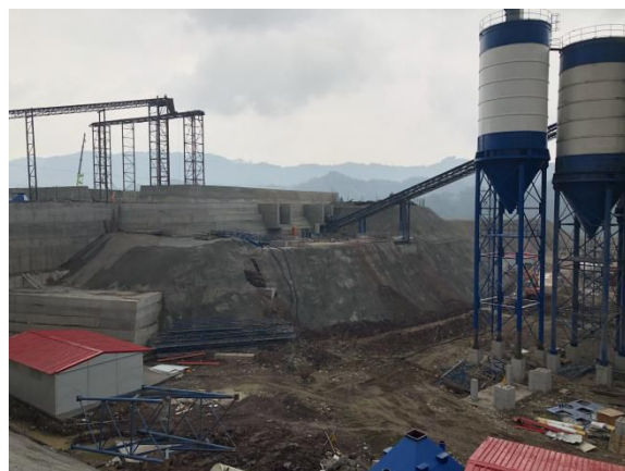
拌合楼边坡硬化
