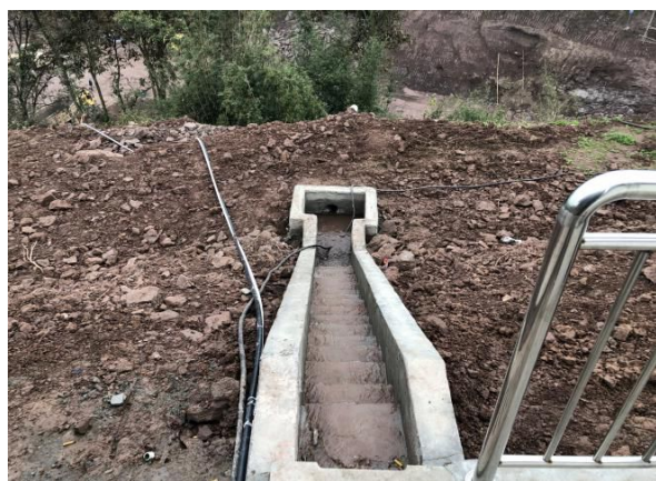
五局拌合楼营地生活用水排水
