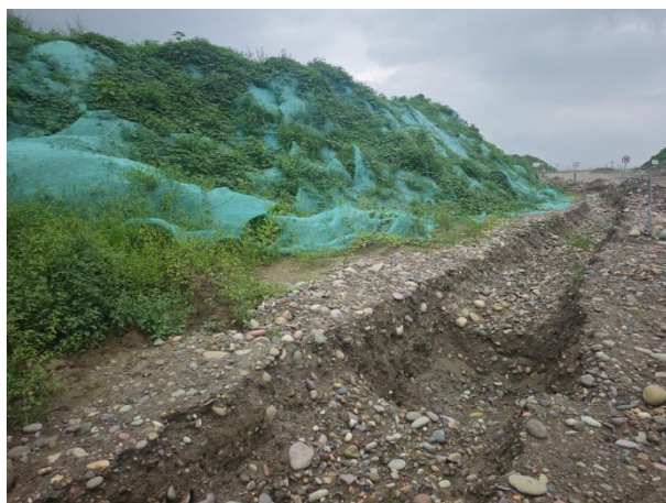
老江坝临时排水设施
